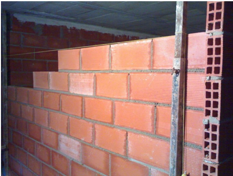
Comparación energética de muro de ladrillo hueco con muro de ladrillo común
